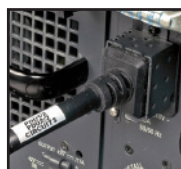
Repérage des installations électriques
