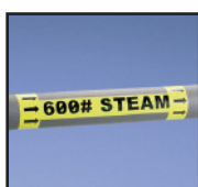
Marquage de tuyaux
